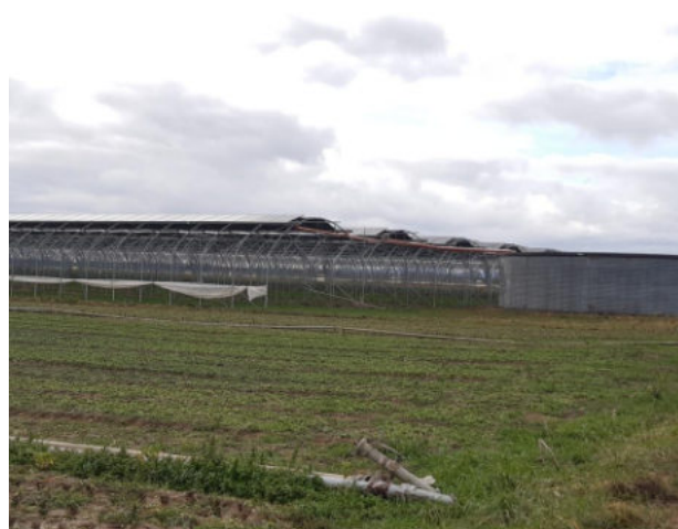
Abb. 2: Agri-Photovoltaik 28.01.2025 Offenbach/Queich. Die Module sind auf einer Tragkonstruktion aufgebracht, die auch als Treibhaus nutzbar und mit großen Geräten befahrbar ist. In diesem Beispiel wird darüber hinaus das Regenwasser in großen Zisternen aufgefangen und zum Gießen wieder verwendet. Foto: Peter KELLER
