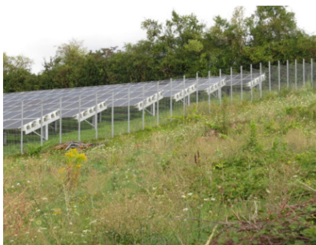
Abb. 1: Einfache Freiflächen-PV-Anlage 02.08.2025 nördlich Landau in der Pfalz. Foto: Peter KELLER
